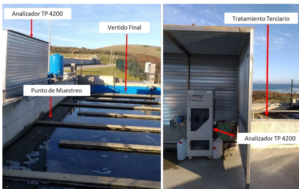
Figura 9.2. Analizador automático TP-4200 en la EDAR de Baiona y punto de muestreo en la salida del tanque de cloración.
