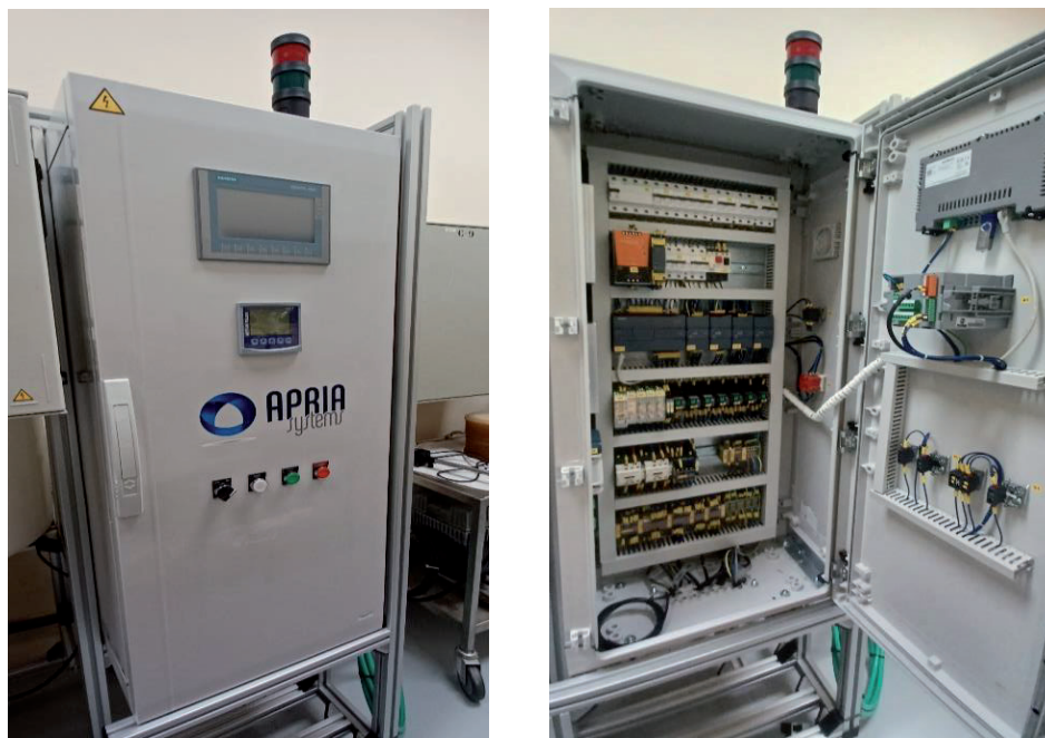
Figura 3-6. Planta piloto Photobench LED275-0.8/LED365-16/450-16a (APRIA Systems): Armario eléctrico.
